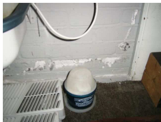
▲ vocht in gevel kelder, door doorslaande muur
